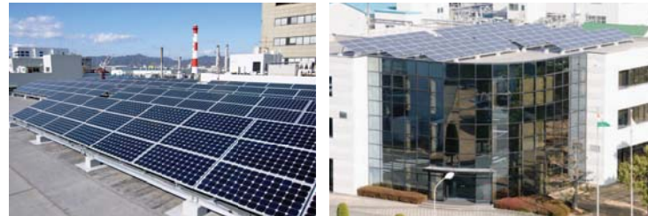
事務所棟に設置された太陽光パネル(徳島事業所)
