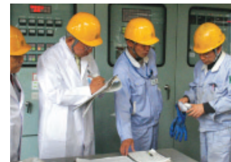
審査状況(焼却炉)
