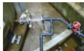
フレキシブル配管対策
