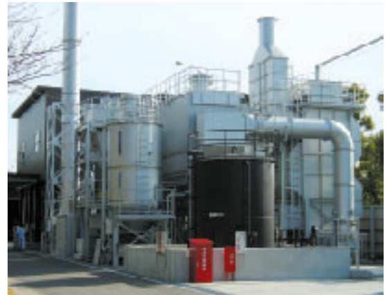
大塚グループ共同焼却炉(大塚製薬(株)徳島第二工場内)
