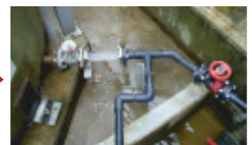
フレキシブル配管対策
