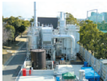
大塚グループ共同焼却炉(大塚製薬(株)徳島第二工場内)
